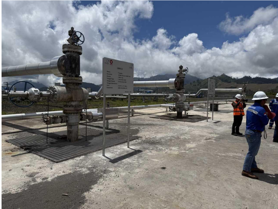
圖 21、電廠生產井場介紹參觀照片
