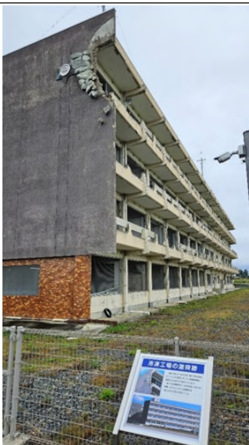
圖 15 向洋高校教室受損情形 3
