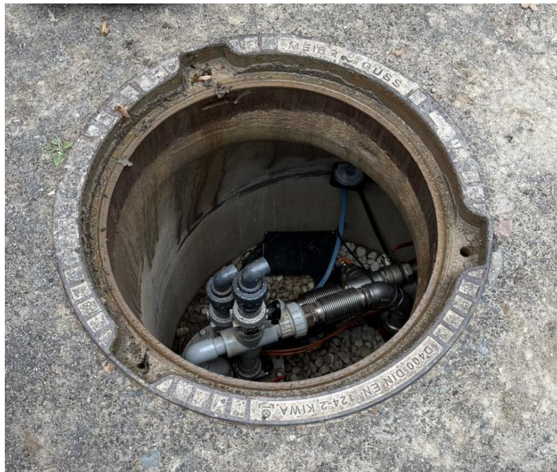
圖 6、地下熱電池案場注水與監測井
