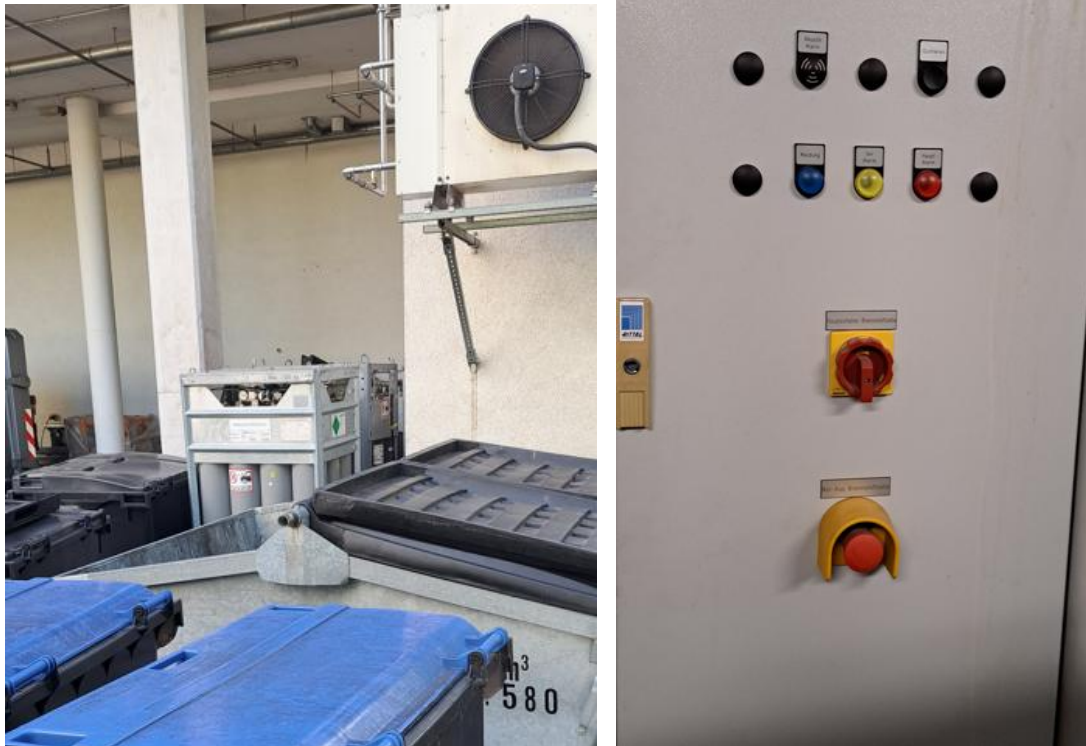
圖 45、燃料電池場域安全裝置(吹掃用氮氣鋼瓶、緊急停機裝置)
