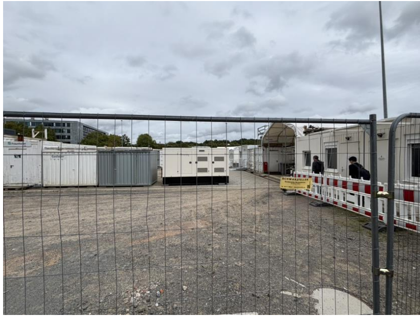
圖 5、地下熱電池案場外圍
