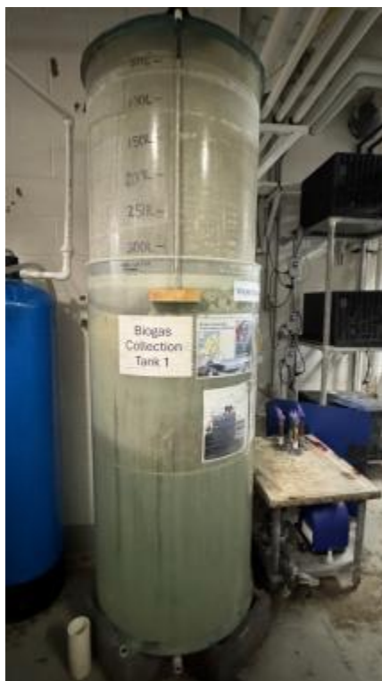
圖七、現場目前可見到三個 Biogas 收集桶槽，且可提供加熱使用。
