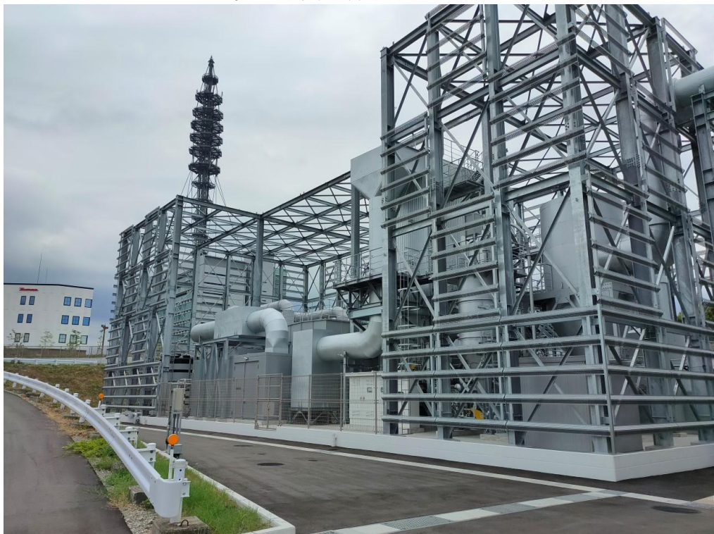
圖 8、中型試驗室廢氣處理設備
