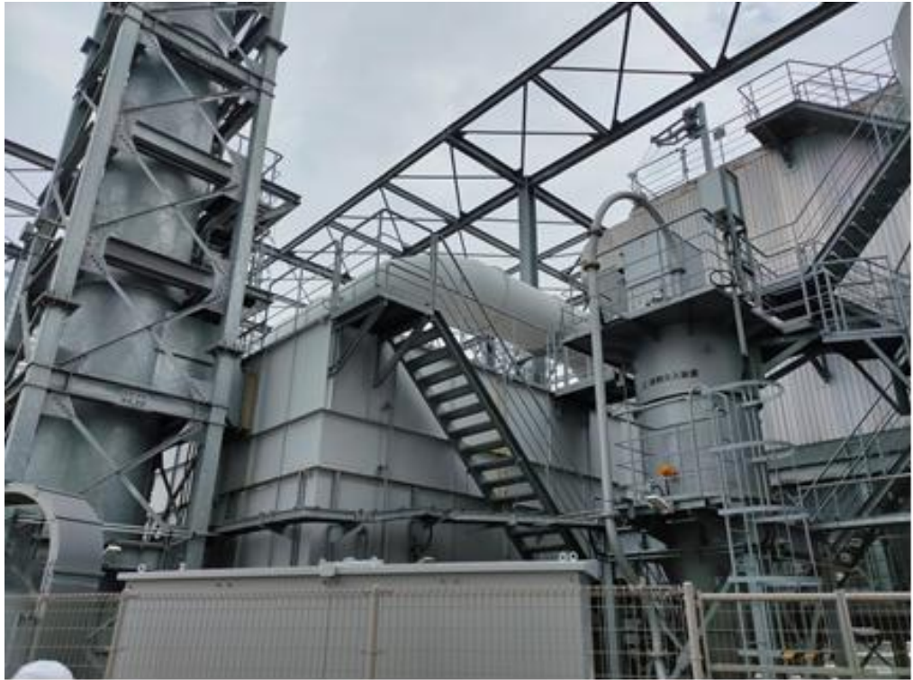
圖 7、多目的實驗棟廢氣處理設備
