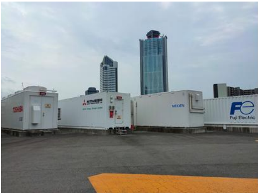
圖 6、提供測試電力之儲能系統(共計 2 MW)
