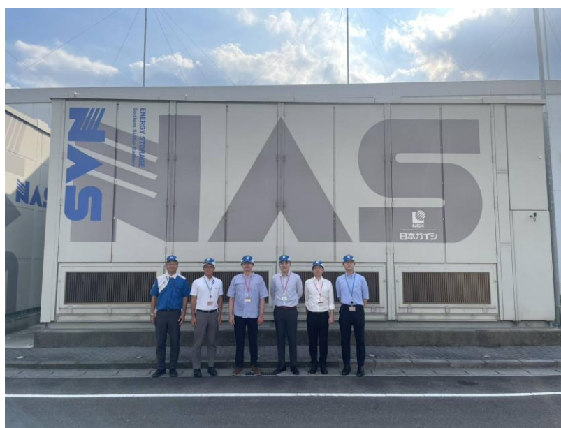
圖 2-2 小牧市工廠內機櫃式鈉硫電池儲能系統
