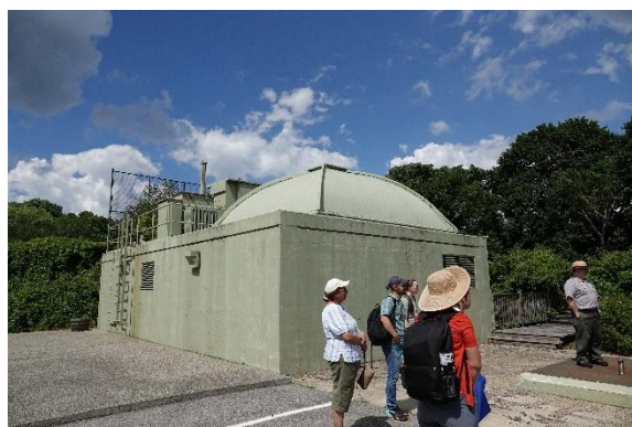
紡織工廠時期水力發電設施(2001 已停止運作)。
