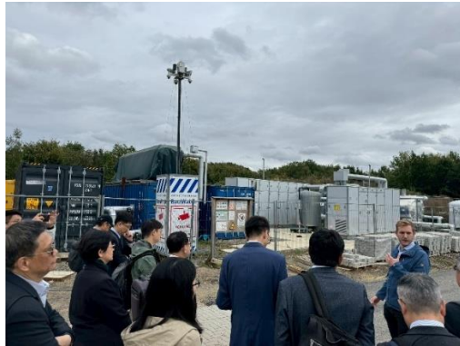
圖3、地熱供熱設備結合太陽能與儲能之複合設施
