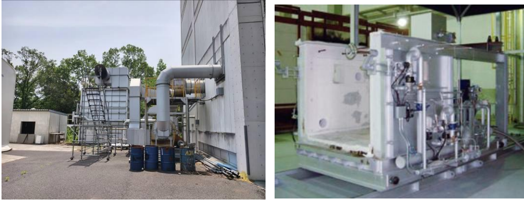
圖 44 二次燃燒爐及中型組合爐
