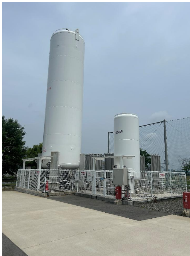
圖 20 草津 RE100 綜合實證場域之液態氫儲槽、汽化器等相關設備
