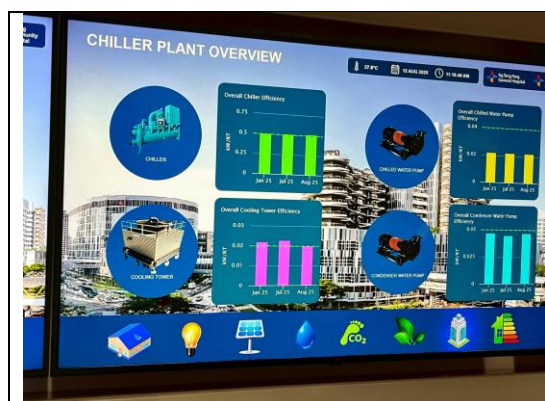
圖 47、冷水機組運作儀表板
