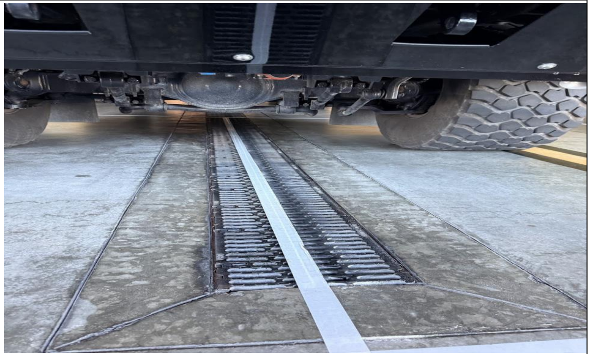
洛杉磯國際機場 80 號消防站車庫地面排水設施
