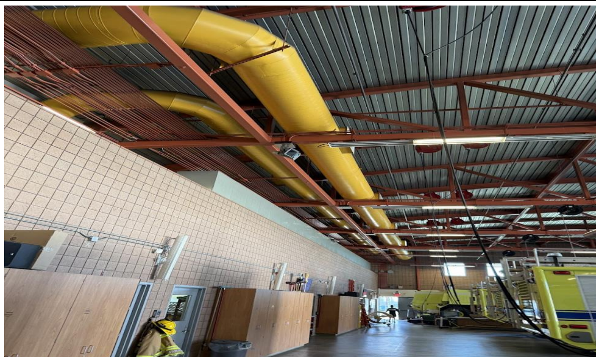
洛杉磯機場 80 號消防站車庫內通風排氣設施
