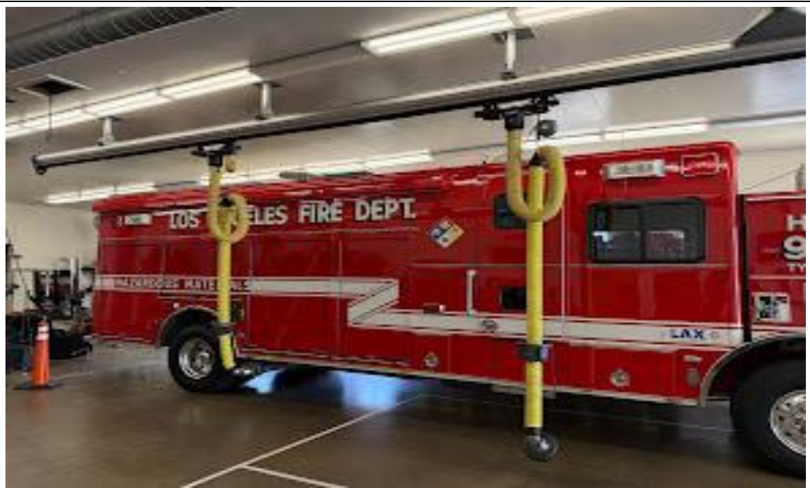
95 號消防站車庫排氣設施
