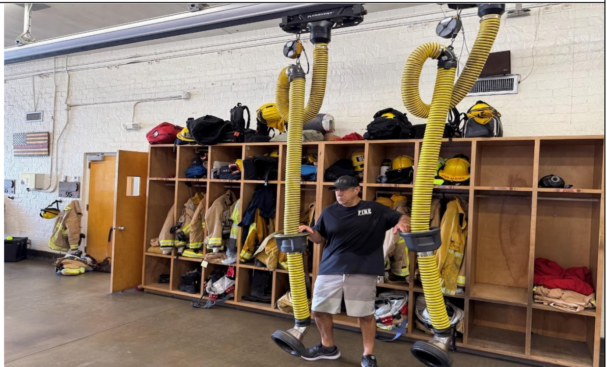
95 號消防站車庫排氣設施(可直接連接消防車排氣管)
