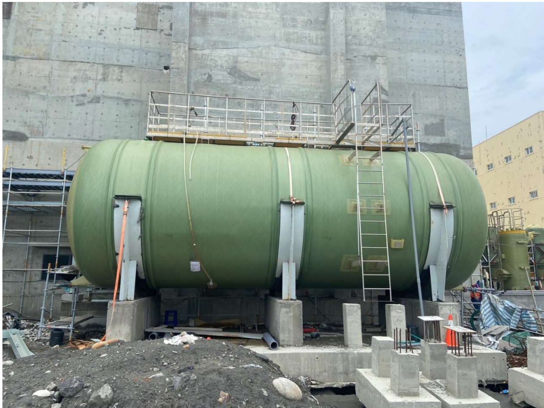
圖 6. 12.5%次氯酸鈉儲存槽
