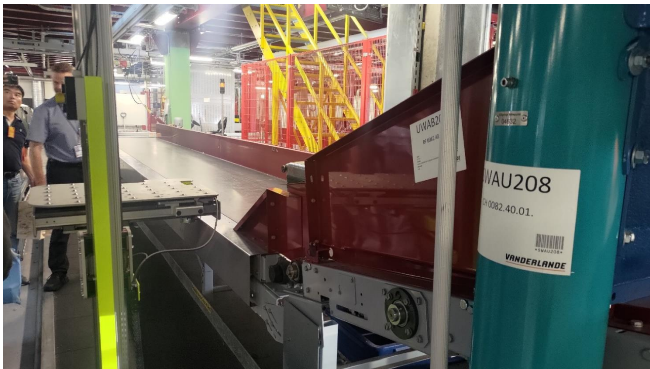
圖 35 哥本哈根機場 BHS 系統(6)
