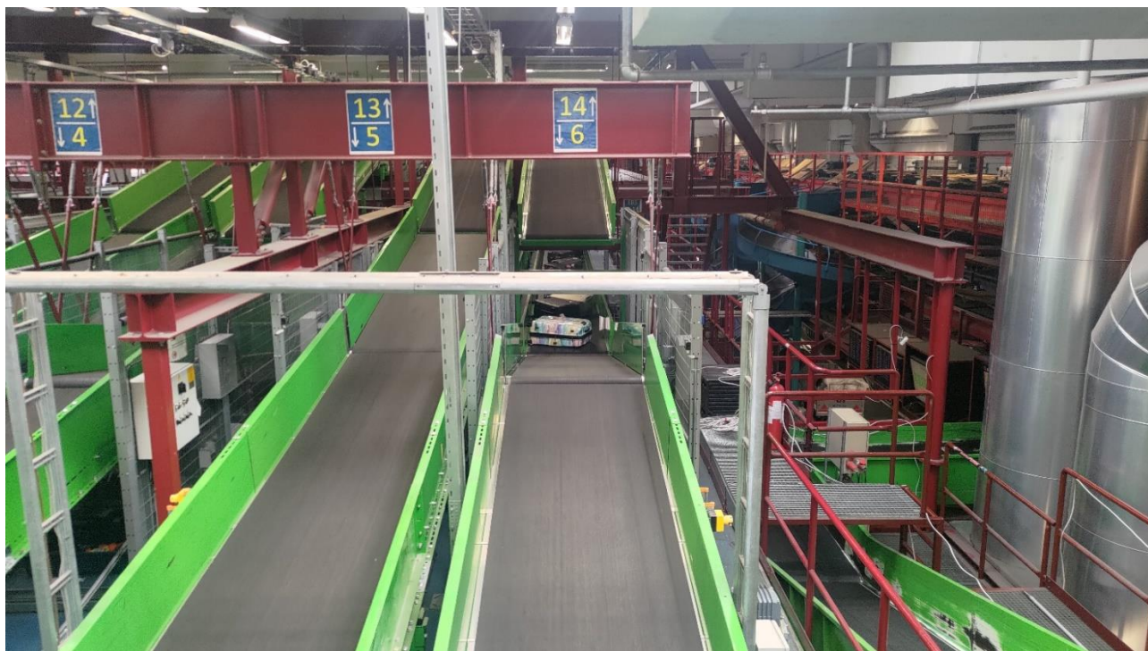
圖 33 哥本哈根機場 BHS 系統(4)
