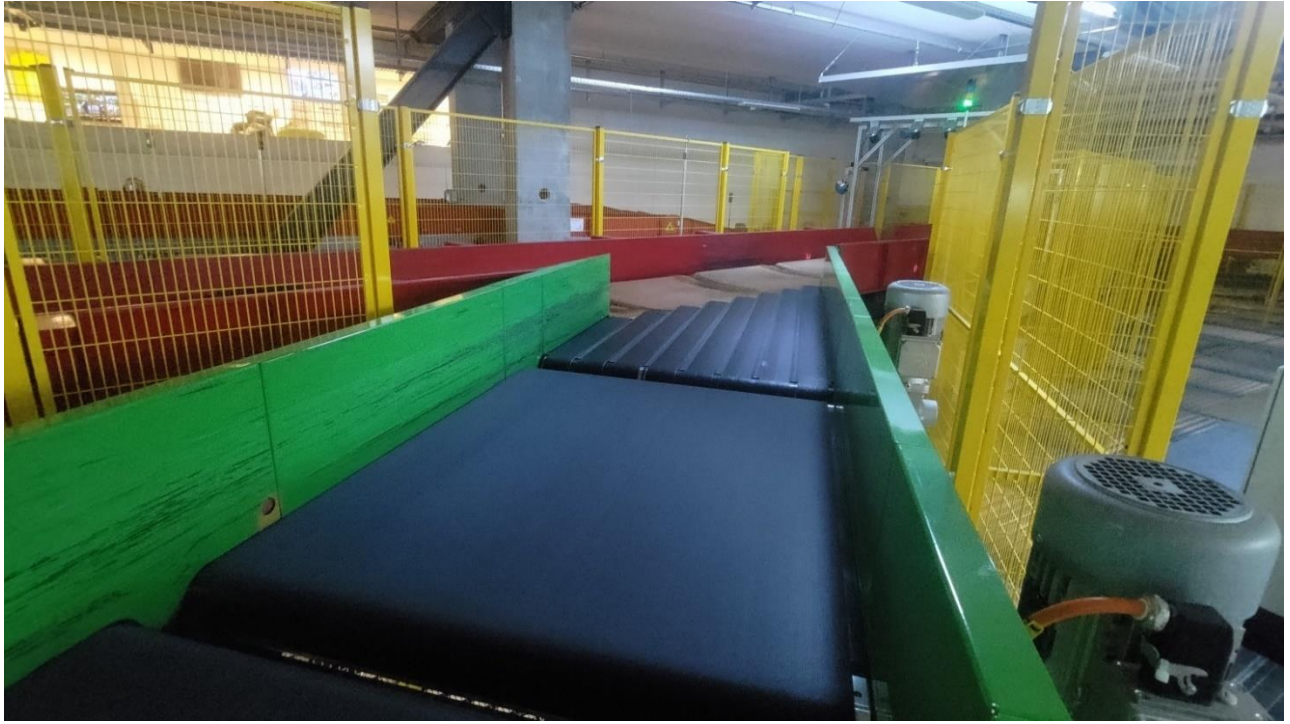
圖 31 哥本哈根機場 BHS 系統(2)
