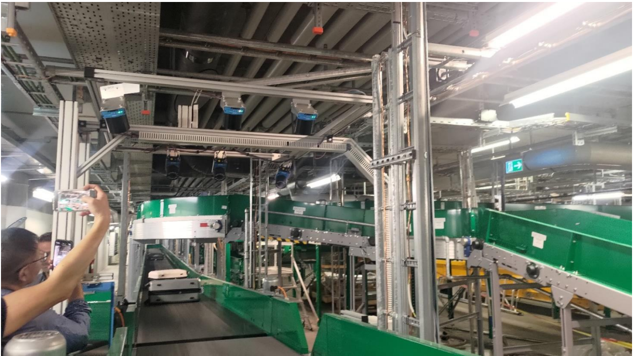
圖 32 哥本哈根機場 BHS 系統(3)
