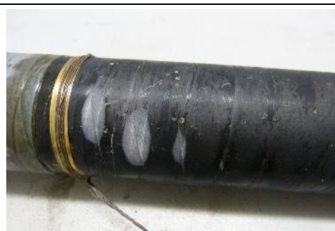
圖 4 部分放電及絕緣老化檢測
