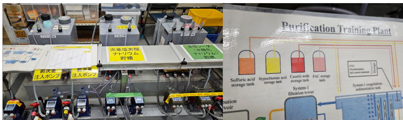
圖 25 操作室儀器標示與訓練教材標示一致性
