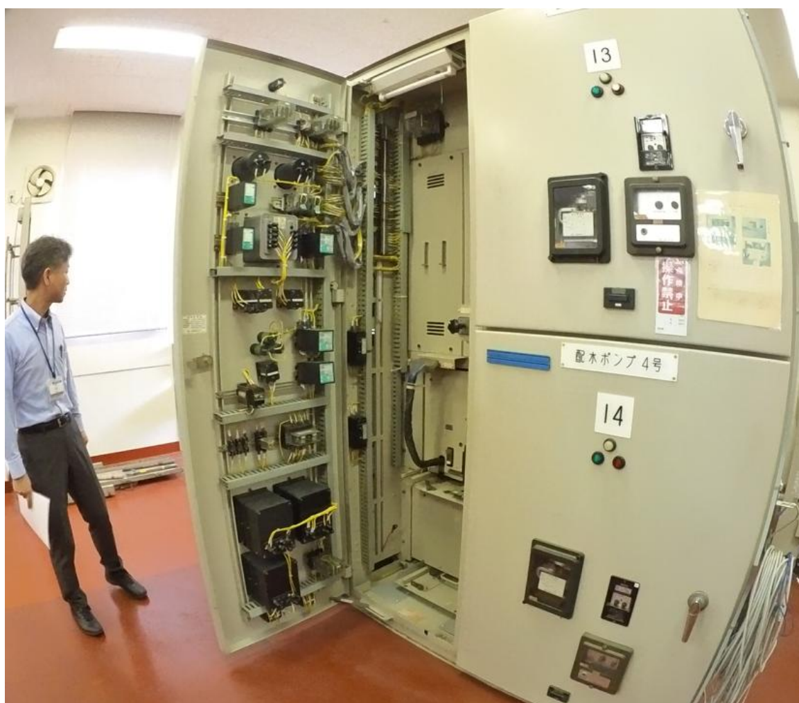
圖 41 水池幫浦配電箱
