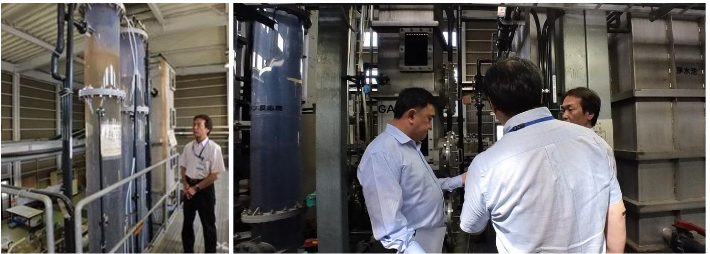
圖 35 左：2F 後臭氧接觸筒與 GAC 吸附池、右：1F 後臭氧接觸筒、GAC 吸附池、清水池
