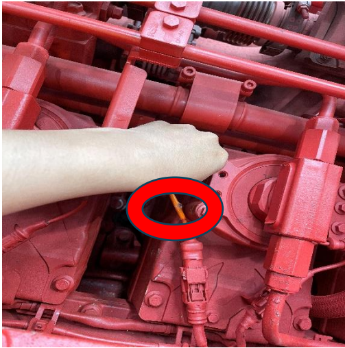
圖 2-14-5 R232 引擎室第七噴嘴感應器 引線破損
