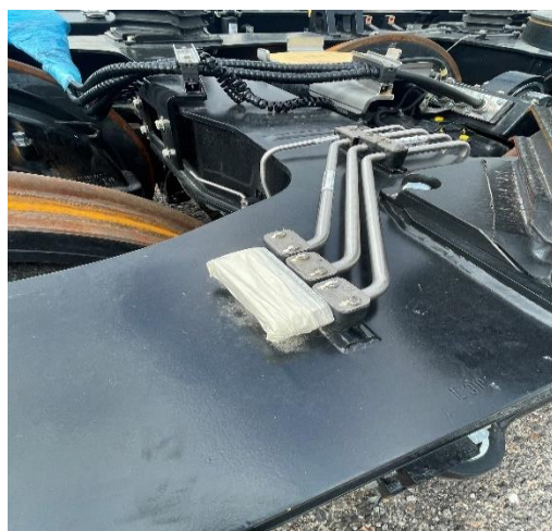
圖 2-17-6 R231 轉向架外露線路及管路需有防護措施(已改善)
