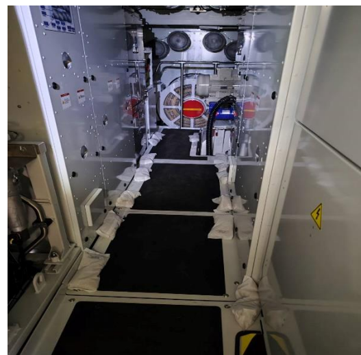
圖 2-7-6 ABB 機蓋未安裝接地線 (已安裝)
