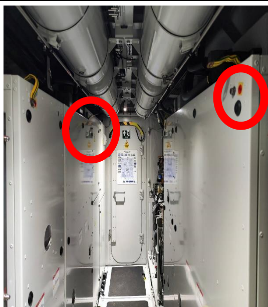
圖 2-5-1 R228 變流器 1、2 箱體接地線未接
