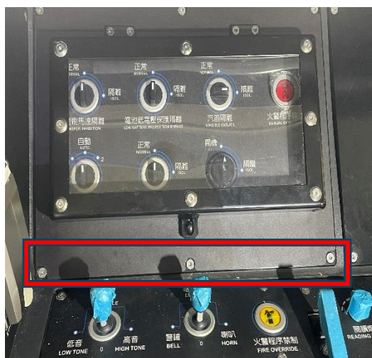
圖 2-18-3 R230 後端助理側蓋板螺絲未 鎖固(已改善)
