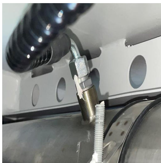
圖 2-16-8 R230 新鮮進氣孔管線未鎖固(已改善)
