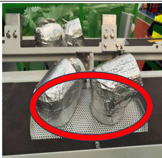
圖 2-11-7 R231 空調管路旁未貼隔熱材質
