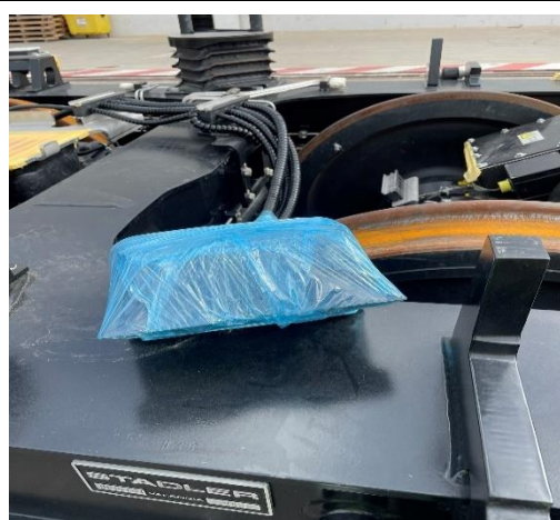
圖 2-17-8 R232 轉向架外露線路及管路需有防護措施(已改善)
