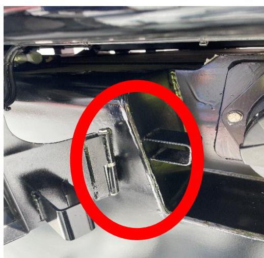
圖 2-5-7 R229 加油孔蓋板漆缺漏 (已修補)
