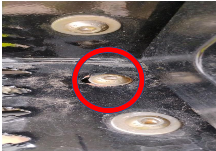
圖 2-2-2 後端左側樓梯踏板沒有墊片位置
