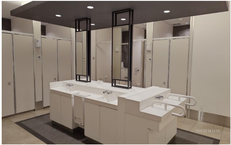
圖 33、廁所內配置及廁間
