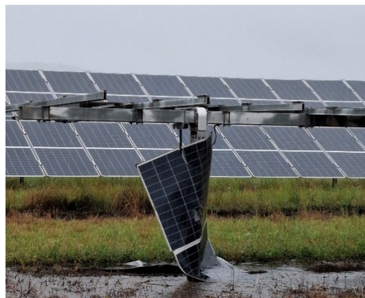
圖 4.2.5 強風吹襲下損壞的光電模組
