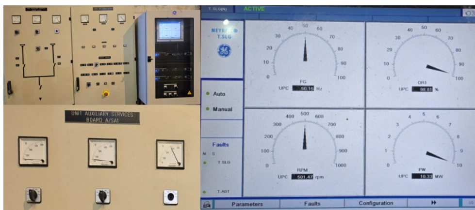
圖 4.2.12 Maguga 電廠採遠端遙控操控
