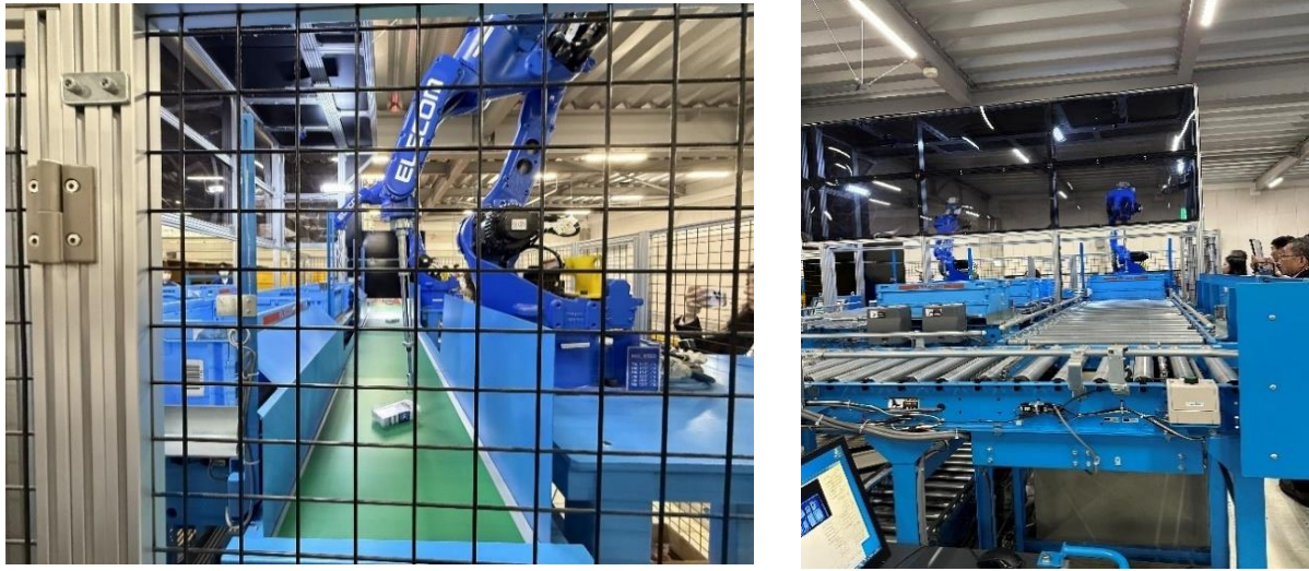
圖 48、AI 影像辨識手臂安全隔離作業區
