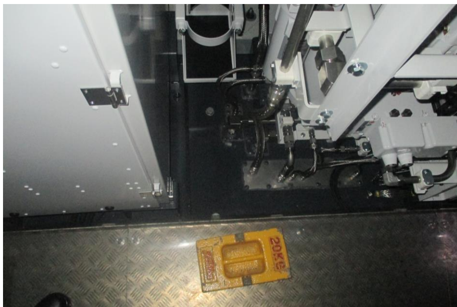
圖 3-1-3-3 機械室走道放置重量塊
