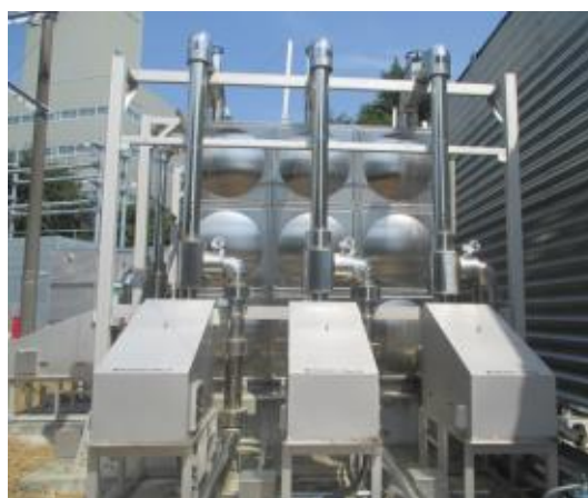
圖3-3-12水密設施水塔
