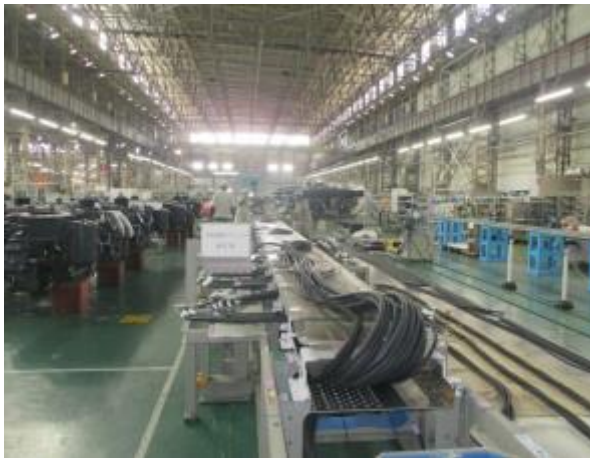
圖1-3-1走道配線－底部
