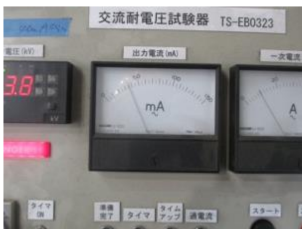
圖 3-4-10 測試漏電流/電流值
