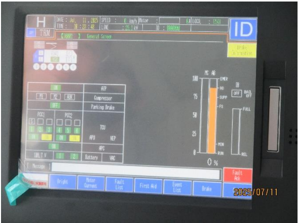
圖 3-8-2-1 螢幕確認設備皆在正常運轉
