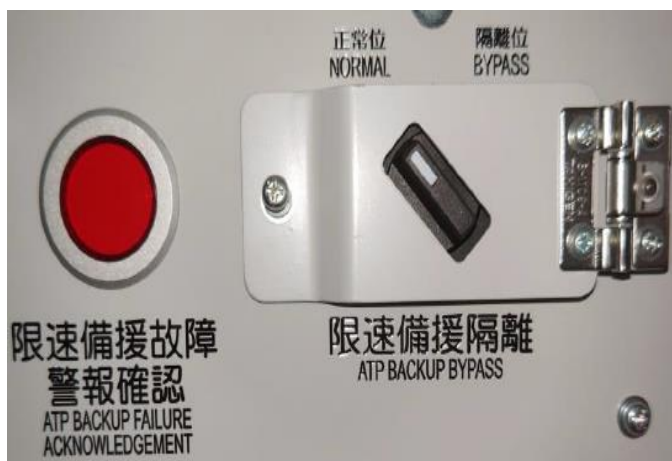
圖 4-9-2-4（警報確認與隔離開關位置）
