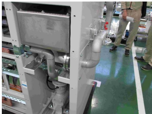
圖 3-53:PCC 冷卻水管進出口
