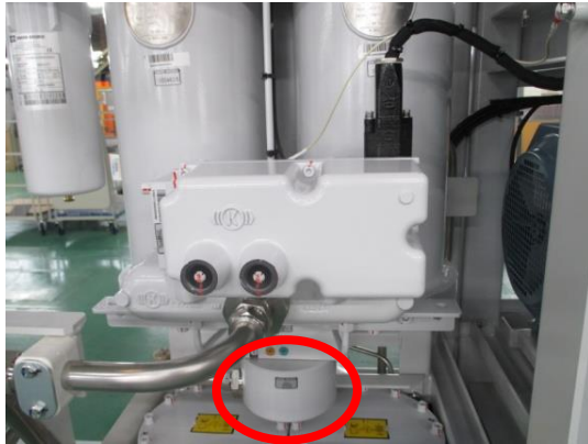
圖 4-2-1-22 冷凝/再生空氣排放口
