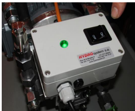
圖 4-3-5-12 注油泵浦開關
