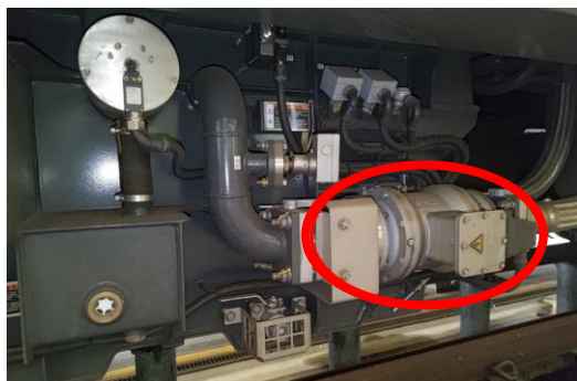
圖 4-3-3-4 油泵 A 側位置
