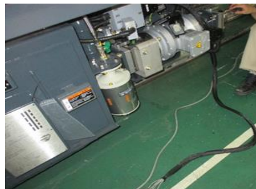
圖 4-3-5-29 變壓器油泵測試線
