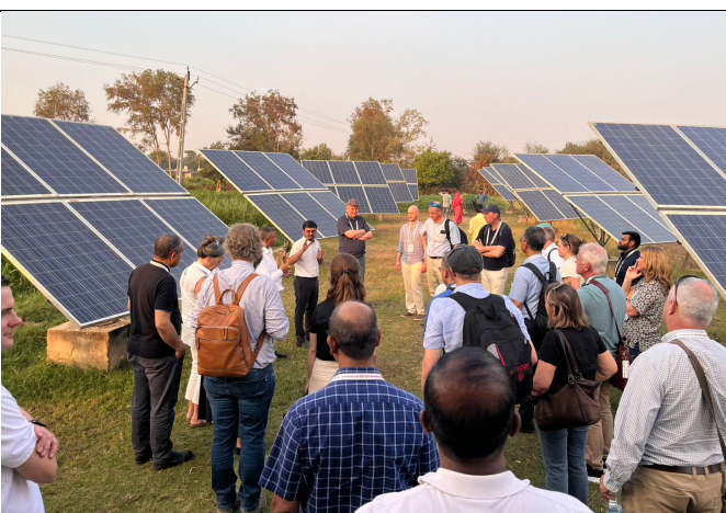
農村太陽能再生能源發電實際使用情況
