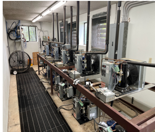
(b)所有冷藏庫壓縮機及冷凝器皆在同一區域散熱。
