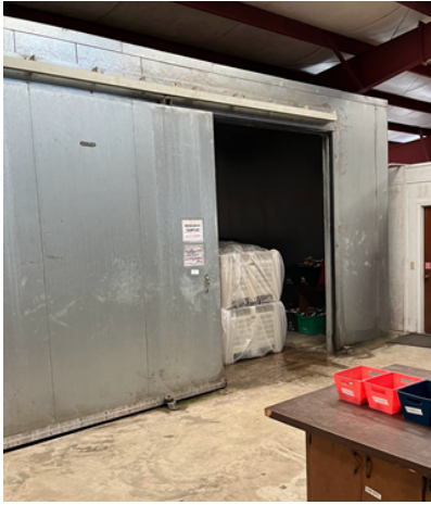
(a)大型冷藏庫。
