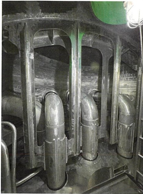
左右為卸料管線，中間為進料管線
