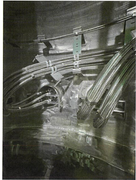
Cargo Pump 電管
