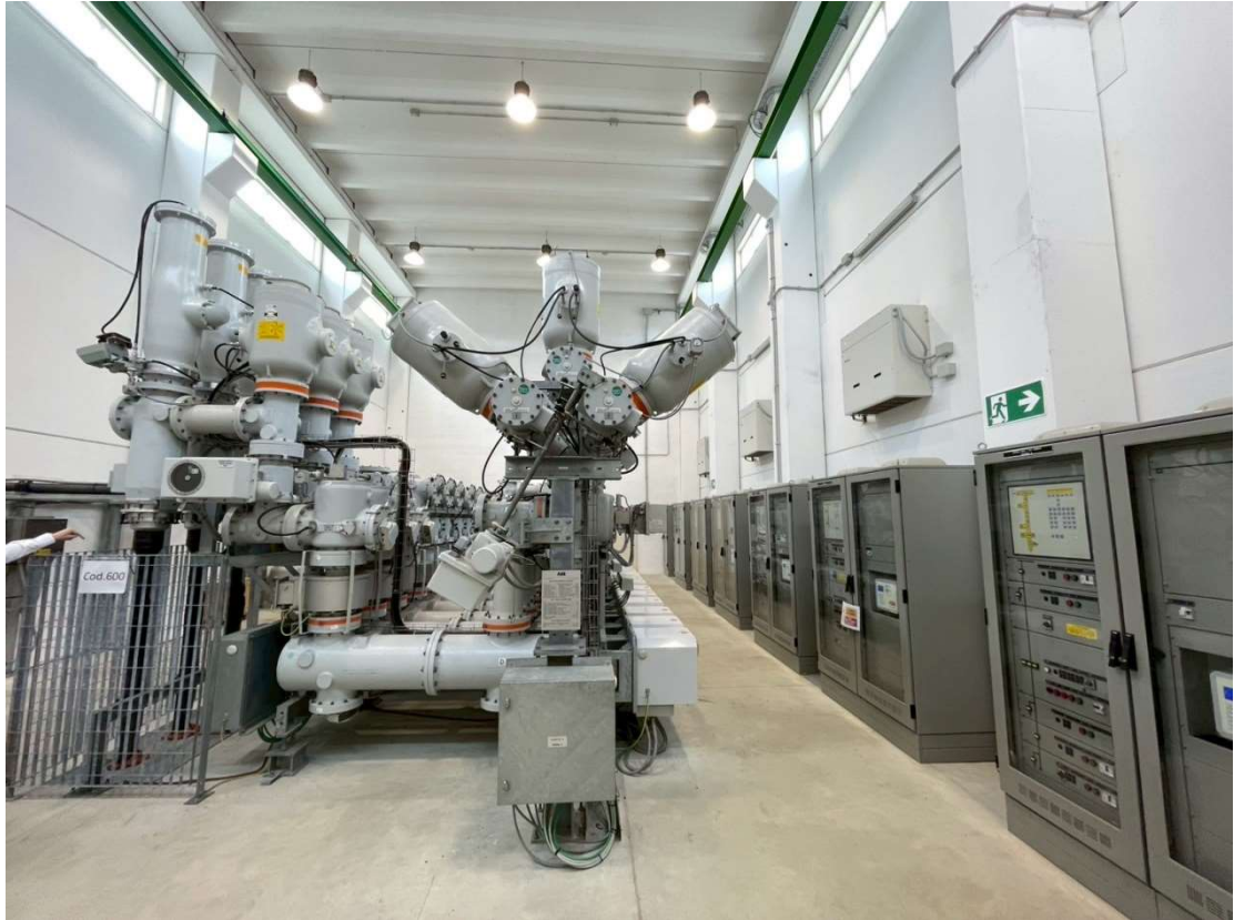
圖 5.4 羅馬機場主變電所 150kV GIS
