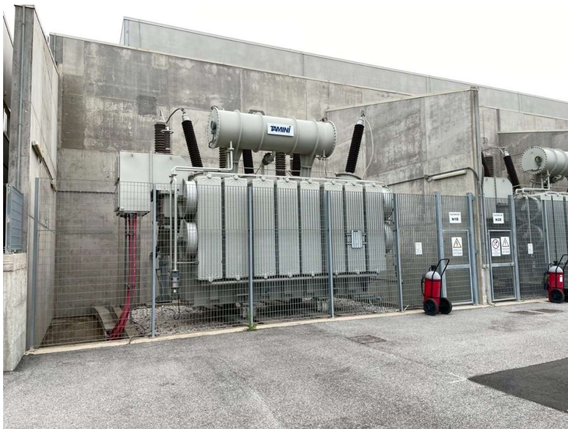
圖 5.8 主變壓器採油浸式變壓器，並配置 SF6 滅火設備
