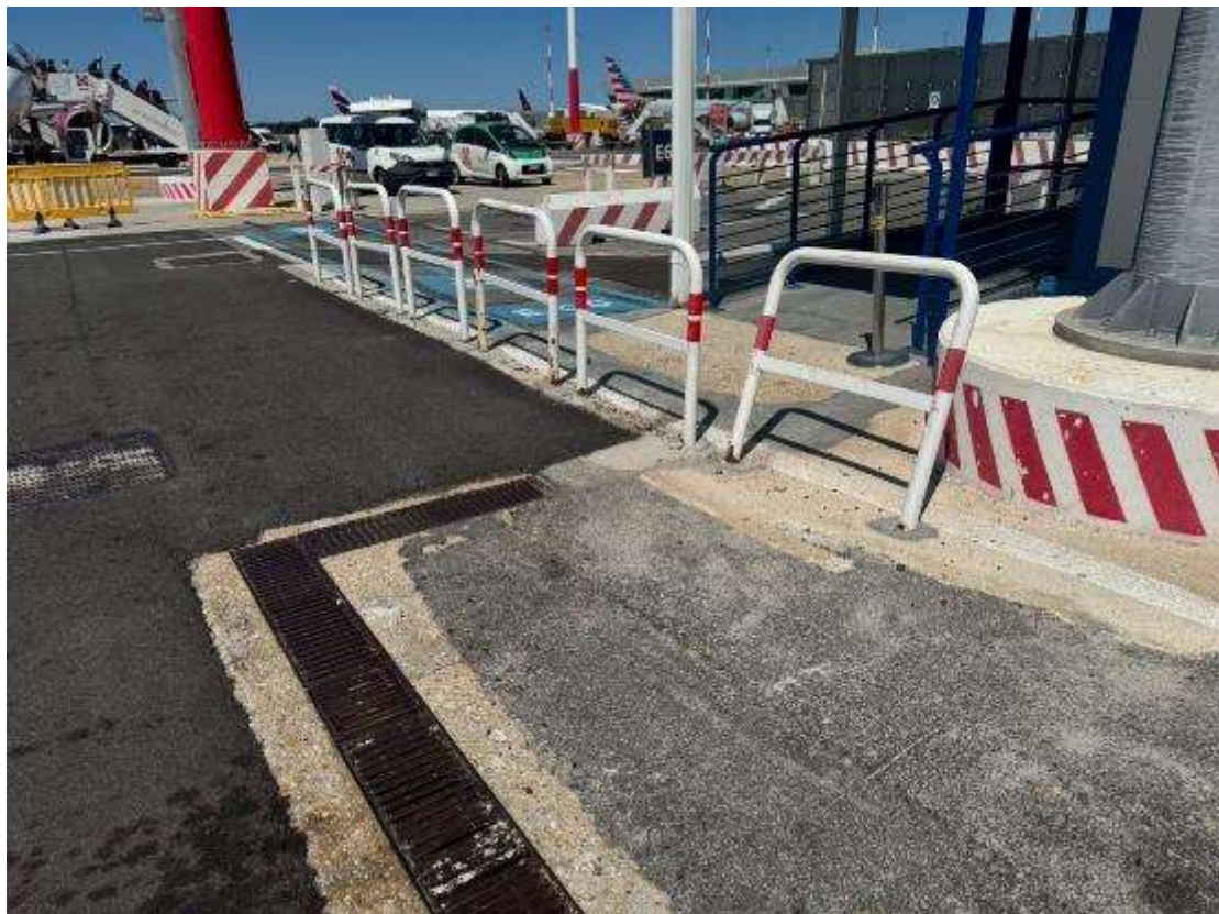
圖 3.6 接駁機坪鋪面狀況較差
