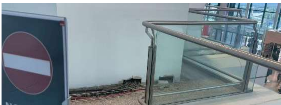
圖 4.50 航廈內多數電纜架裸露設置情形
