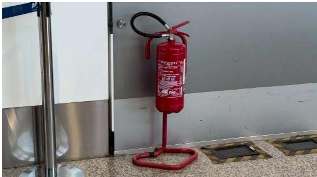
圖 4.54 航廈隨處可見滅火器
