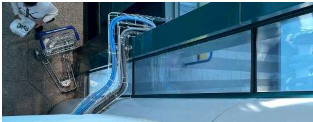
圖 4.49 航廈內多數電纜架裸露設置情形
