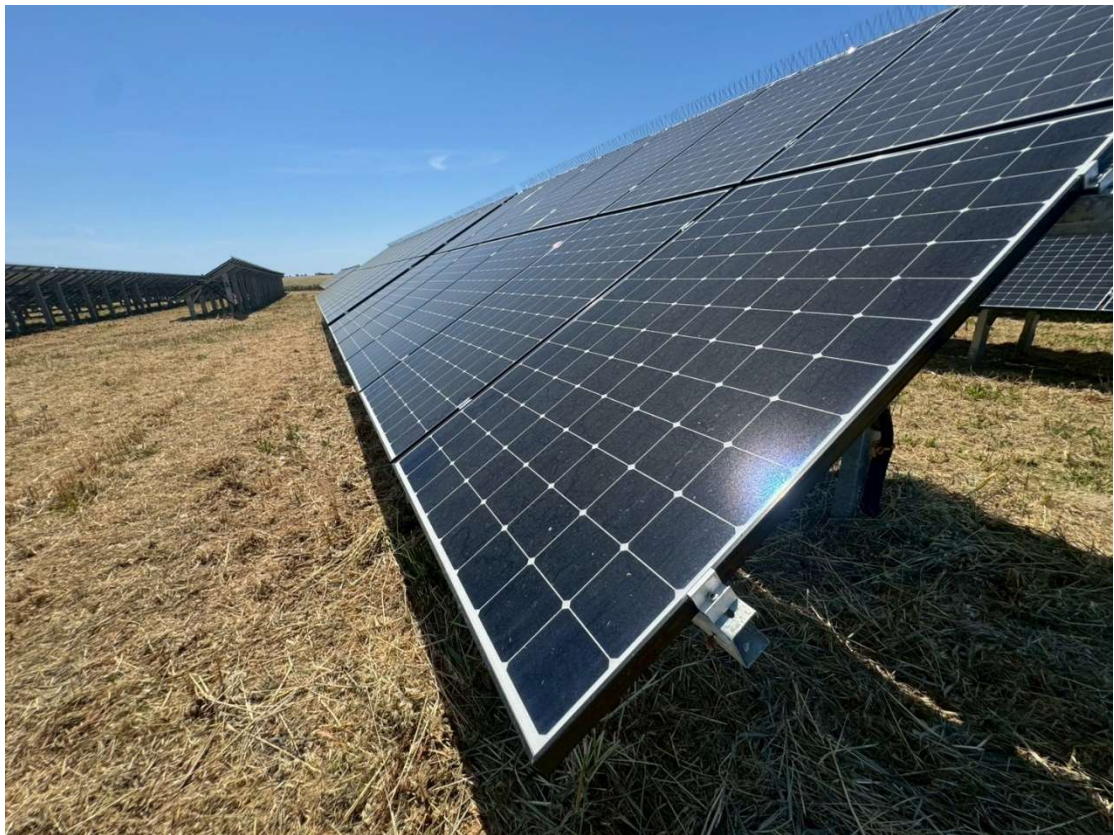
圖 6.8 太陽能板仍有些微反光情形
