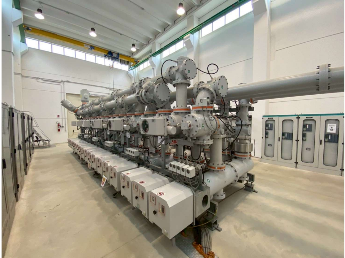
圖 5.3 羅馬機場主變電所 150kV GIS
