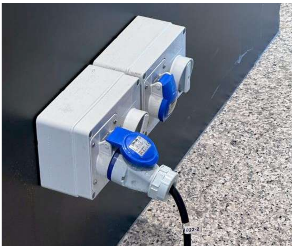
圖 4.48 航廈內多數插座皆設置保護裝置
