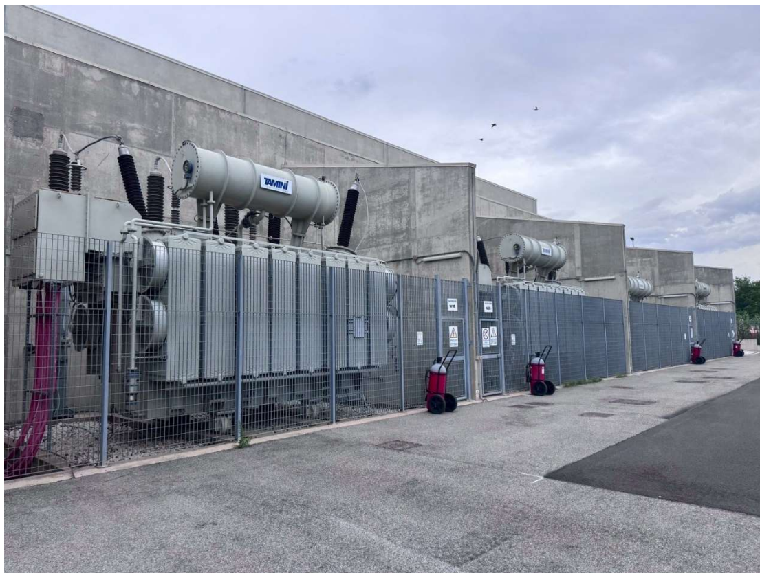
圖 5.7 羅馬機場 4 組主變壓器
