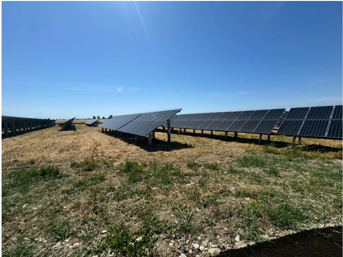
圖 6.7 羅馬機場跑道旁太陽能系統設置向陽面
