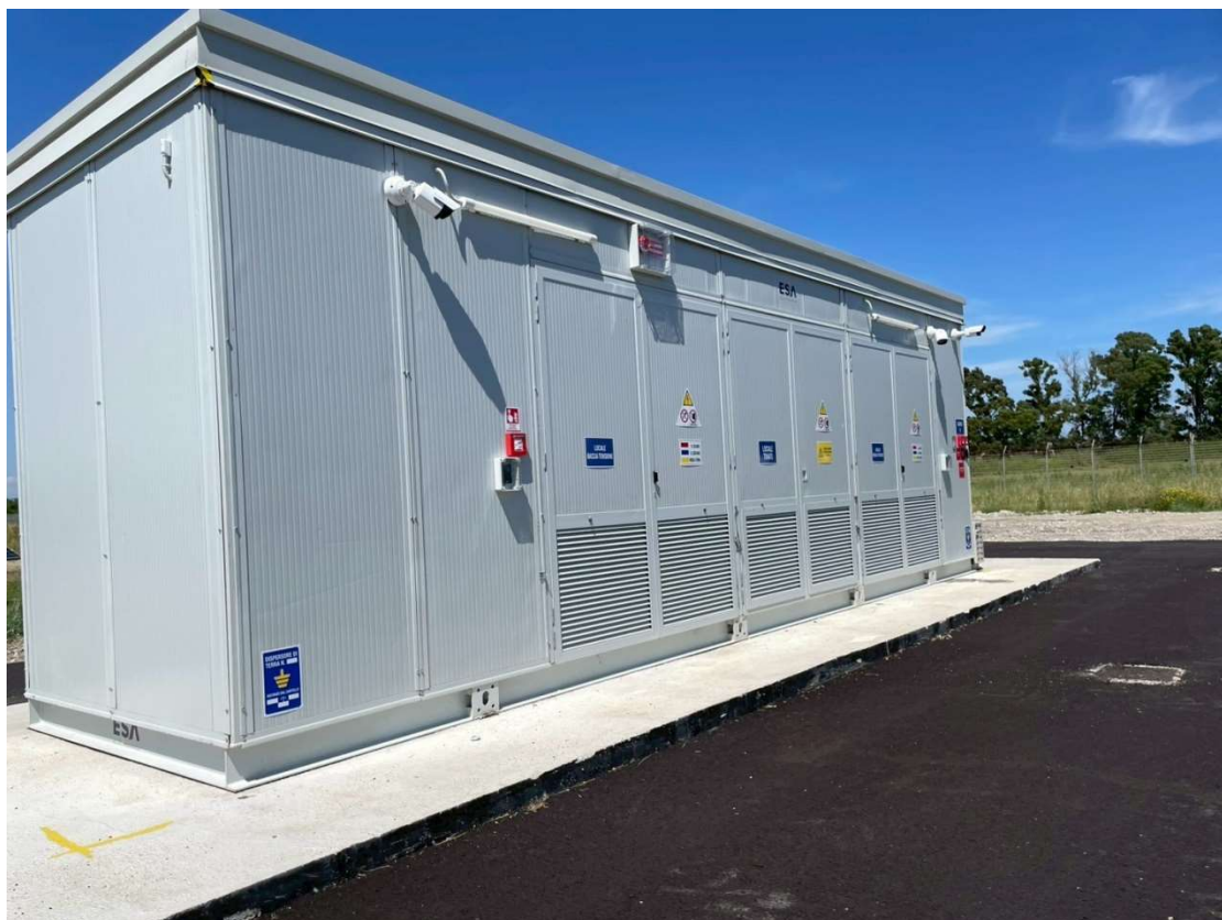
圖 6.12 太陽能系統昇壓站
