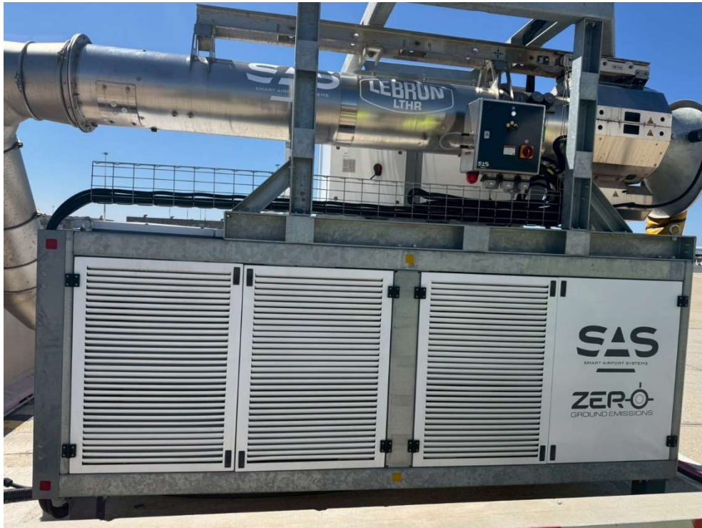
圖 3.29 羅馬機場岸電設施
