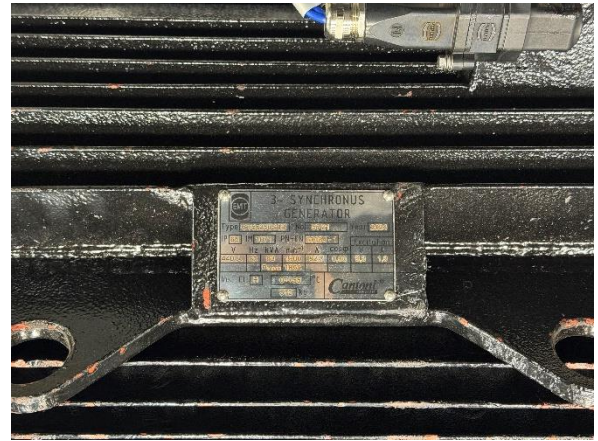
圖 22 測試發電機銘牌
