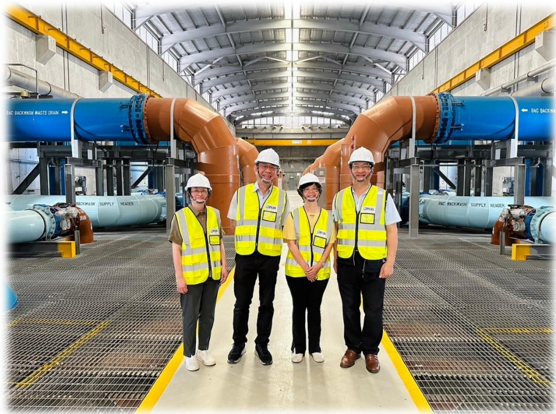
圖 4.3 蔡厝港淨水廠廠區設備空間規劃寬敞方便維修
