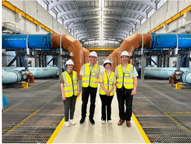
圖 4.16 蔡厝港水廠廠區設備空間規劃寬敞方便維修
