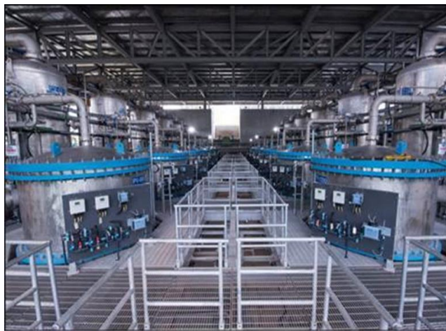
圖 4.2 蔡厝港自來水廠 (CCKWW) 內部陶瓷膜過濾設備
