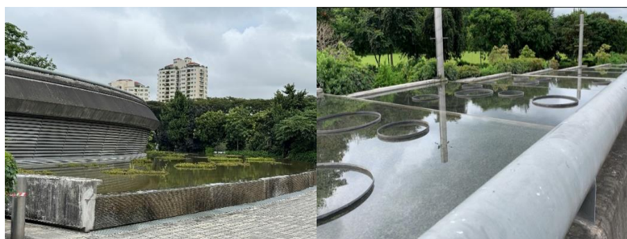
圖 3.3 海淡廠雨水收集處理池 圖 3.4 海淡廠雨水收集管線及處理池
