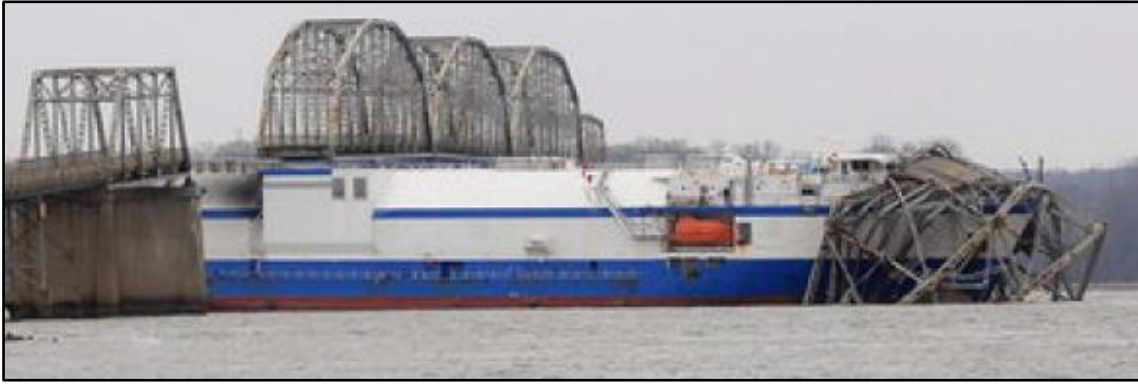
圖3-16 埃格納渡口橋損壞情況 2
