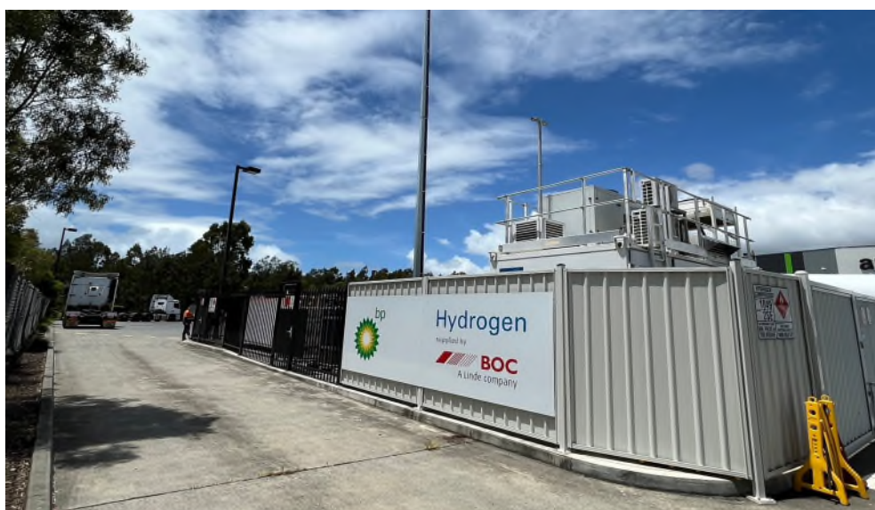
圖 24 BP Lytton 加氫站儲氫罐與加壓設施
