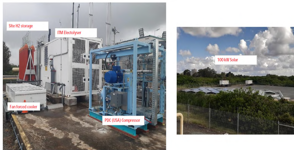
圖 19 廠內製氫電解槽與儲氫相關設施(林德集團提供)
