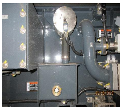
圖 4-5-2-5 過壓釋壓閥測試
