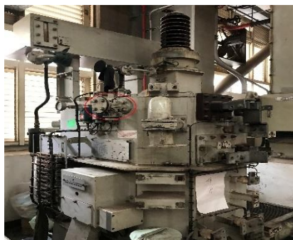
圖 5-2-2 主變壓器注油孔
