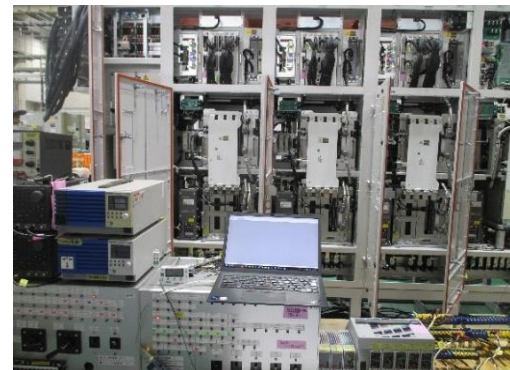
圖 4-1-3-22 模擬監控設備(2)
