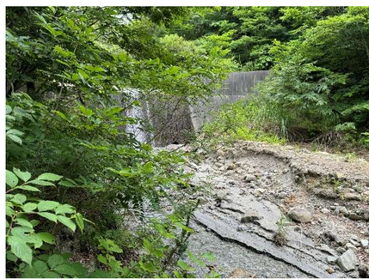
圖 46 防砂構造物與溪流現況
