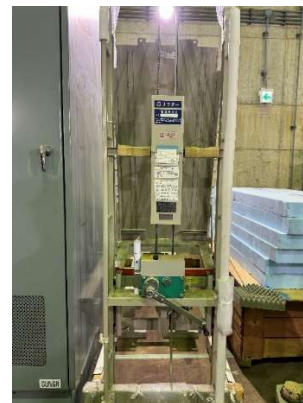
發電廠內部關機具
