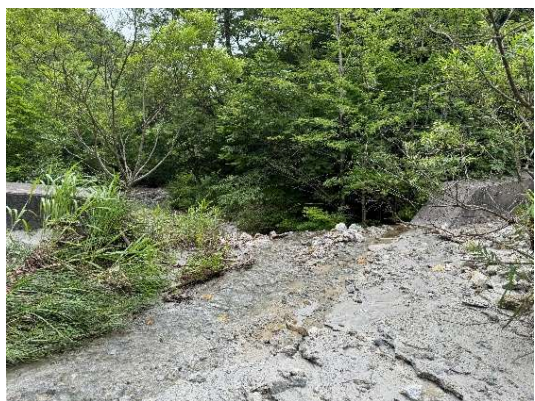
圖 45 防砂構造物與溪流現況
