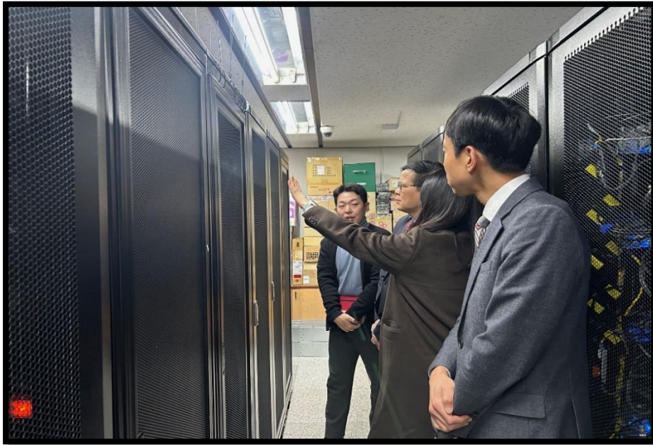
圖 14：KCSC 保存畫面影像的機房設備
