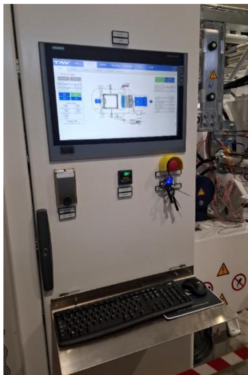
圖 20 HMI 操作界面與控制面板
