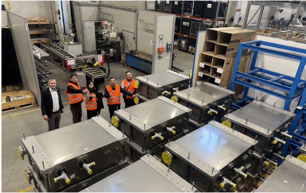
圖 40 檢視本案細水霧設備分區閥均已安裝就緒
