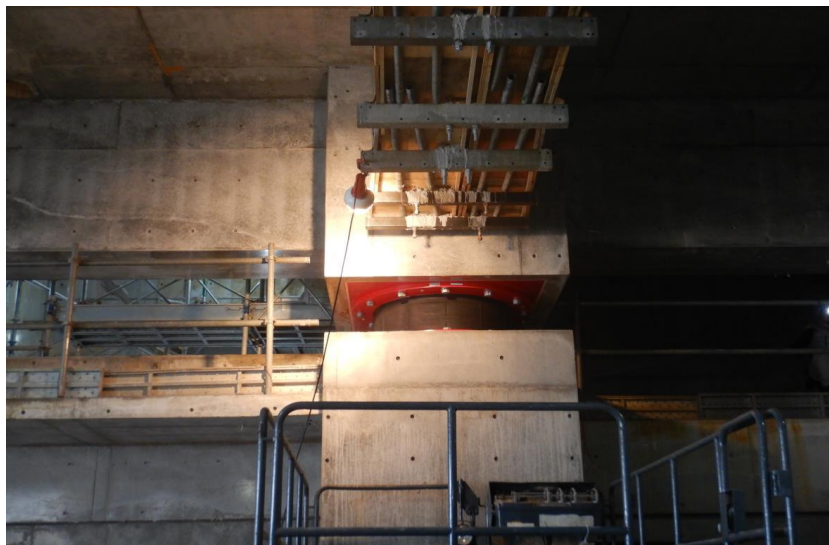
圖 35、免震裝置(來源：橫濱市消防局)
