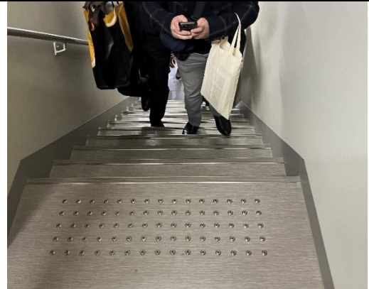
圖 88、樓梯安全裝置
