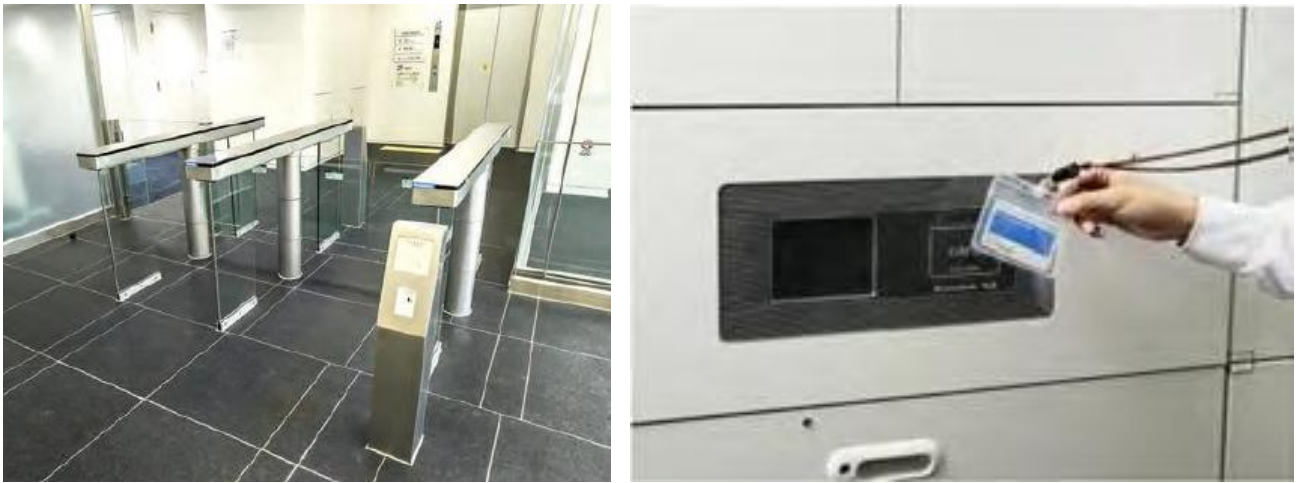
圖 41、安全門及出入館管理系統(來源：橫濱市消防局)
