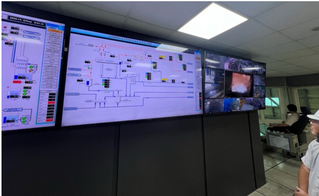
圖 13、綠星環境有限公司焚化處理設施中控系統
