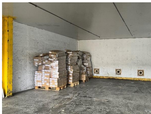
圖 28. 溴化甲烷燻蒸室內部構造。
