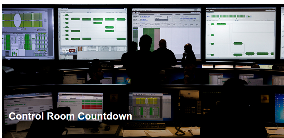
圖 10、國家點火設施監控室
