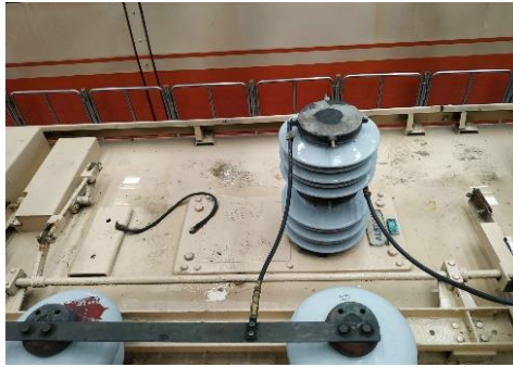
圖 5-4、改裝 GE 電力機車電磁空氣式真空斷路器總成外觀
