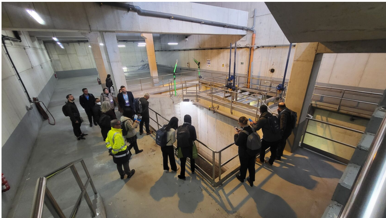
圖 5、ETXEBARRI STORMWATER 雨水蓄水池
