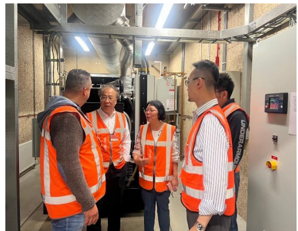
圖 2-3 ADB 現地解說(燈控發電機房)
