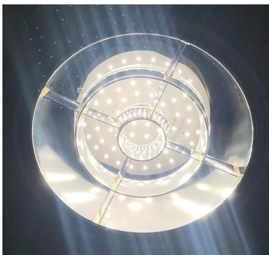
圖 3-32 大範圍照明的區域 LED 燈具(資料來源：Munich 機場)
