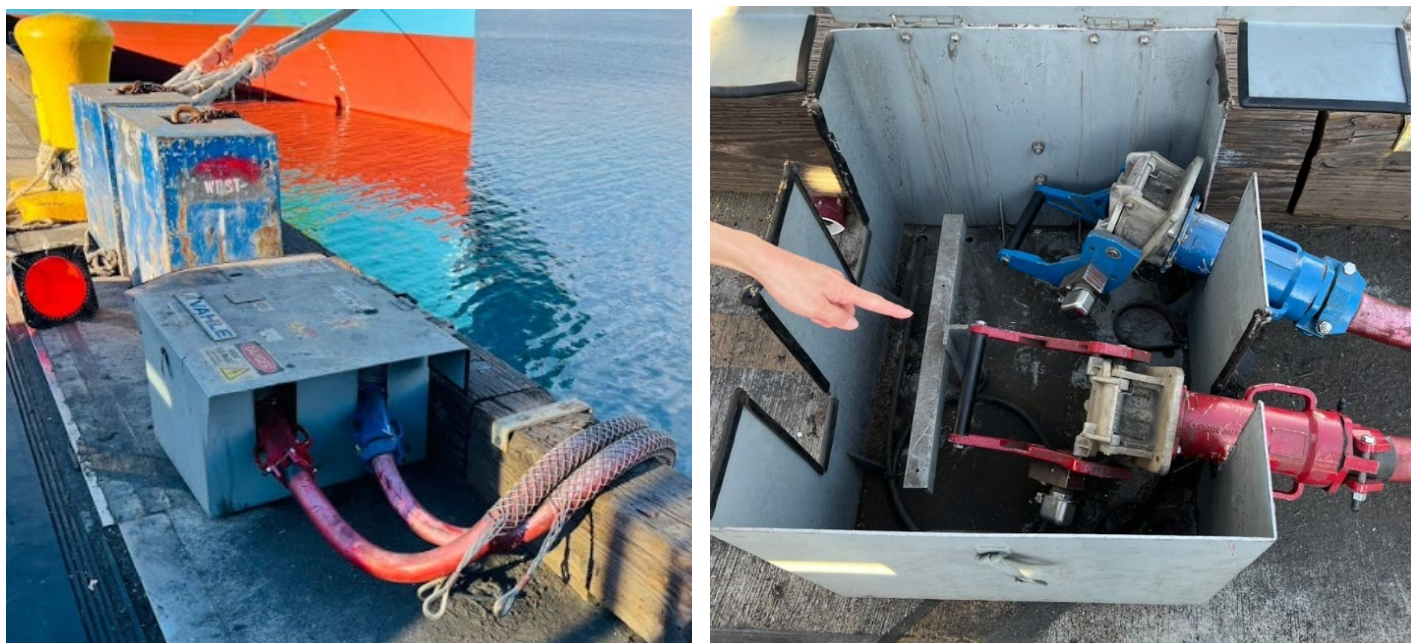
圖 5、WBCT 碼頭自行設置之延伸式岸電設施
