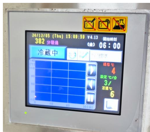
圖18：廚房內冷凍及復熱設備設定面板
