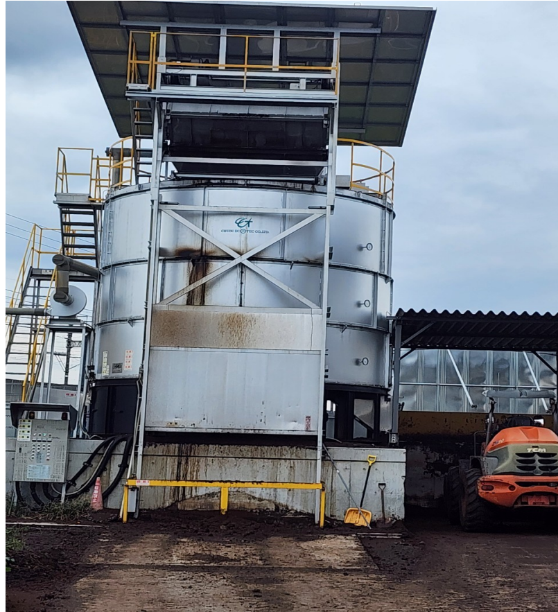
有機堆肥設備
