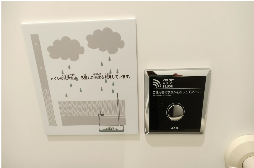
廁所用水為雨水回收
